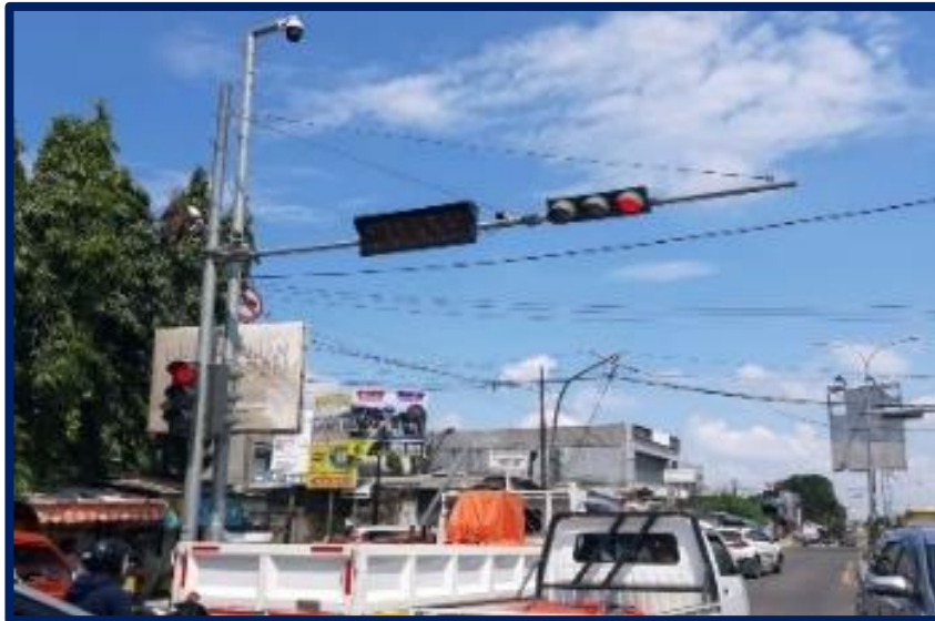
Gambar 5. 8 Dokumentasi Traffic Light dan Camera/Detector
