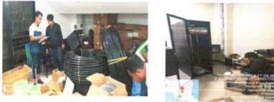
Gambar 4. 70 Instalasi CCTV dan Jaringan Fiber Optic
