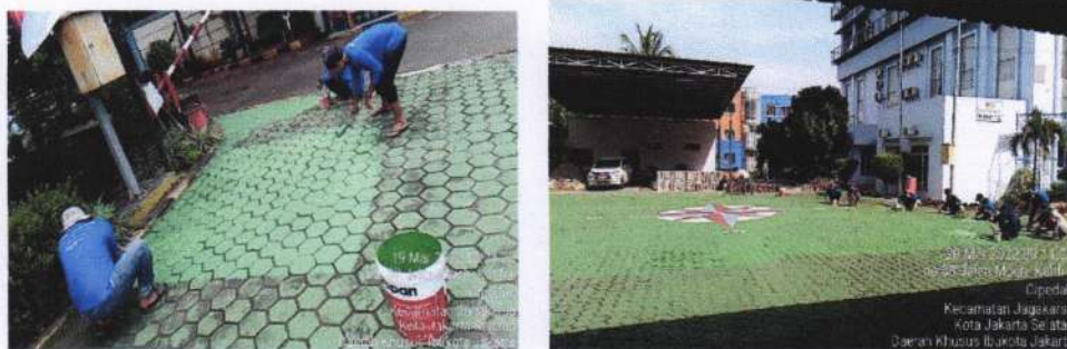
Gambar 2. 30 Pelaksanaan Kegiatan Padat Karya Pekerjaan Pemeliharaan Paving Block Halaman di kampus BP2TL Jakarta
